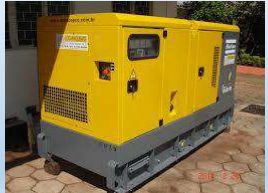
Grupo Motogerador externo
